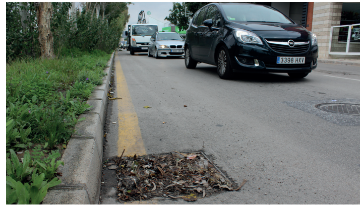
Una de las rejillas de pluviales atascada. J. L. J.
